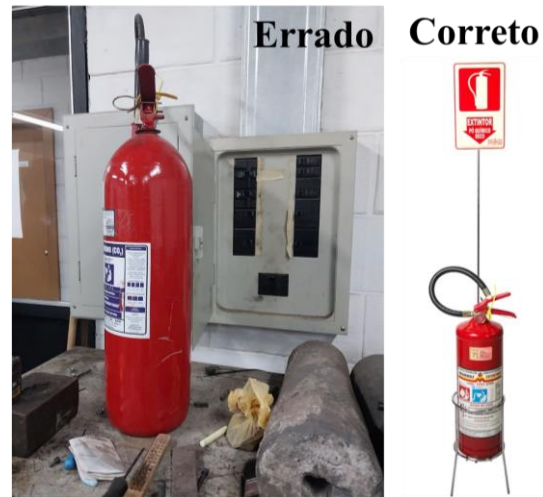
Figura 2. Posicionamento do extintor de incêndio (Fonte: Autoria própria).
